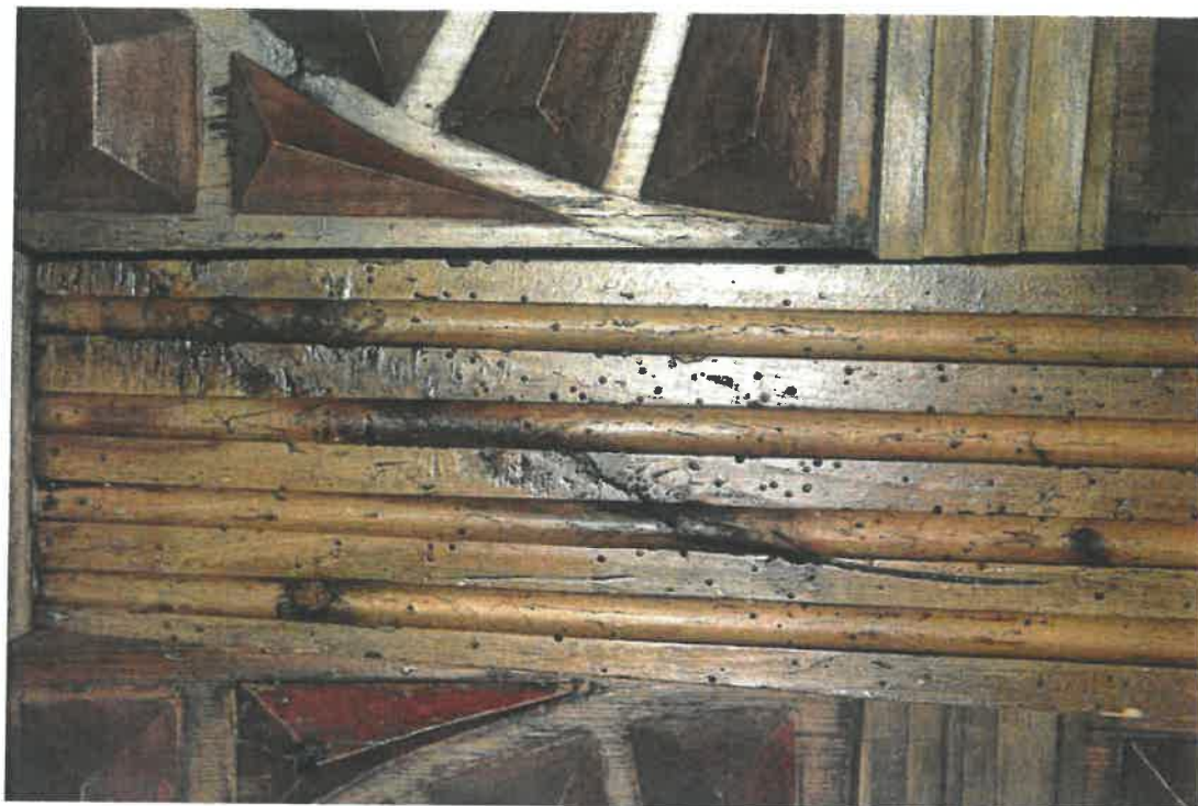
Fot. 42 kościół parafialny pw. Znalezienia Krzyża Świętego, w Łazanach. Elementy wystroju i wyposażenia wnętrza. Stalle. Silna działalność drewnojadów, widoczna na powierzchni jednego z pilastrów dzielących zaplecki.
