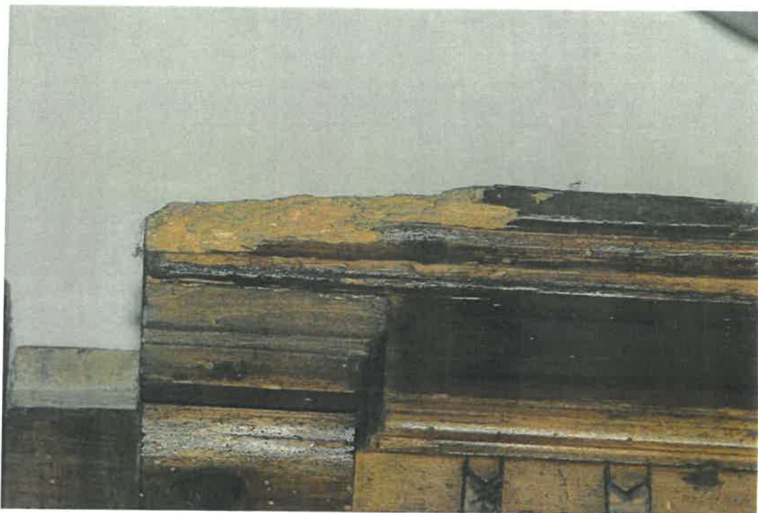
Fot. 41 kościół parafialny pw. Znalezienia Krzyża Świętego, w Łazanach. Elementy wystroju i wyposażenia wnętrza. Stalle. Uszkodzony fragment górnego gzymśowania, z widocznymi bardzo licznymi kanałami, działalności drewnojadów.
