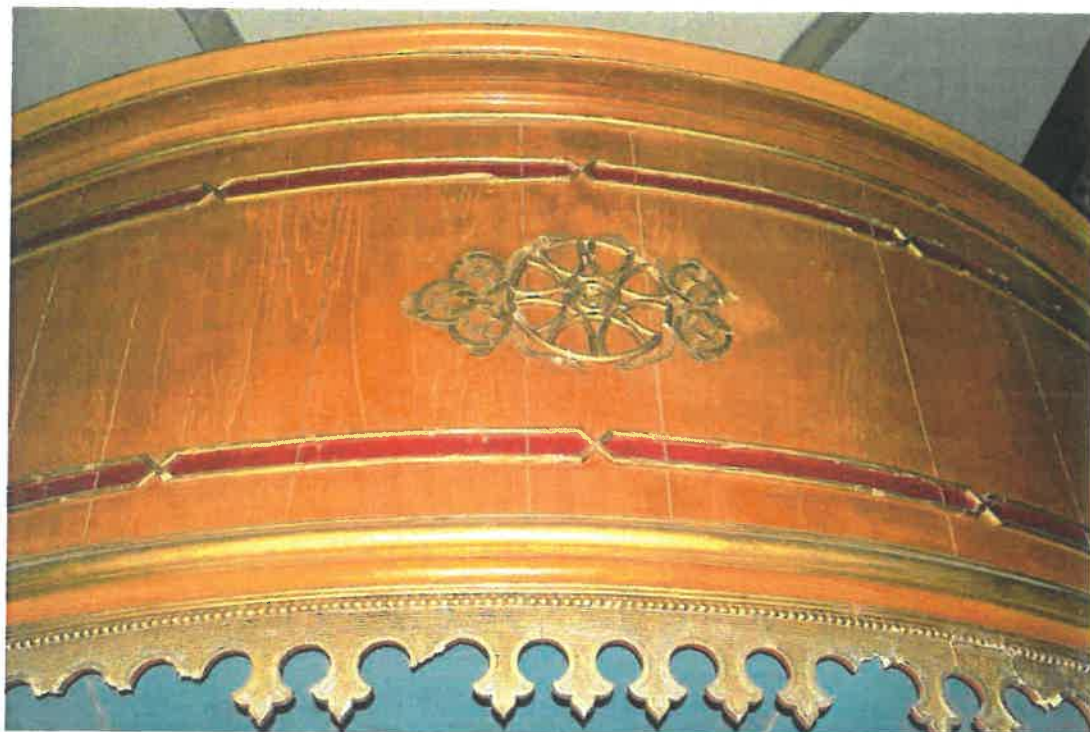
Fot. 48 kościół parafialny pw. Znalezienia Krzyża Świętego, w Łazanach. Elementy wystroju i wyposażenia wnętrza. Liczne drobne ubytki widoczne na dekoracji snycerskiej, środkowej części parapetu chóru.
