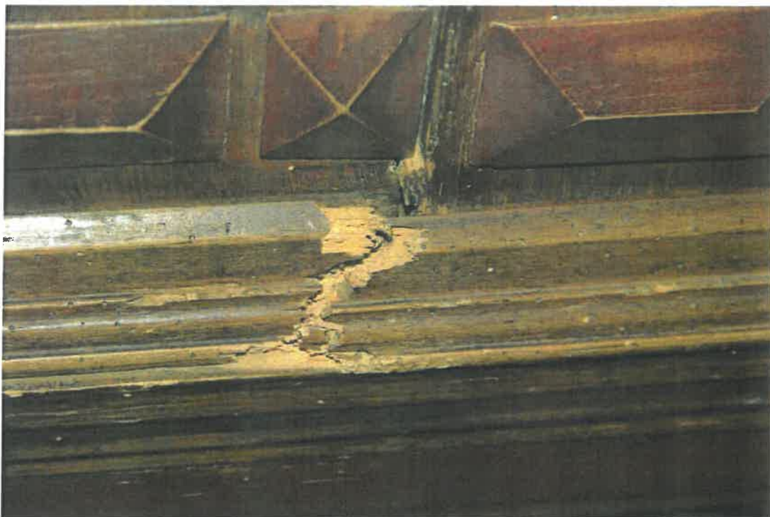
Fot. 43 kościół parafialny pw. Znalezienia Krzyża Świętego, w Łazanach. Elementy wystroju i wyposażenia wnętrza. Stalle. Pęknięcie dolnej listwy gzymsowania pierwszego zaplecka, spowodowane bardzo silną działalnością owadów.
