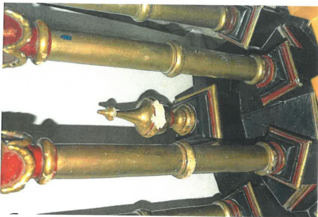
Fot. 33 kościół parafialny pw. Znalezienia Krzyża Świętego, w Łazanach. Elementy wystroju i wyposażenia wnętrza. Ambona. Duży ubytek zaprawy, na elemencie ozdobnym, podstawy mównicy.
