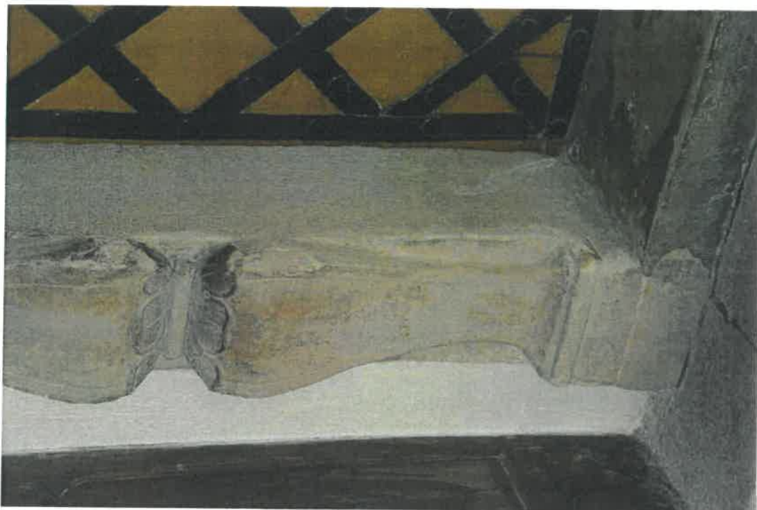
Fot. 88 kościół parafialny pw. Znalezienia Krzyża Świętego, w Łazanach. Elementy wystroju i wyposażenia wnętrza. Portal kamienny wejścia do kościoła z kruchty wejścia bocznego. Lewy węgar z widocznymi wcześniejszymi uzupełnieniami ubytków.
