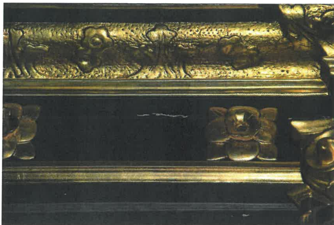
Fot. 18 kościół parafialny pw. Znalezienia Krzyża Świętego, w Łazanach. Elementy wystroju i wyposażenia wnętrza. Prawy ołtarz boczny. Pęknięcie deski w środkowej części górnej części ołtarza.
