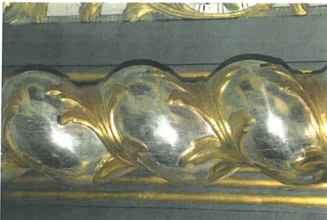
Fot. 19 kościół parafialny pw. Znalezienia Krzyża Świętego, w Łazanach. Elementy wystroju i wyposażenia wnętrza. Prawy ołtarz boczny. Seria drobnych spękań warstwy zaprawy widoczna na jednej z kolumn.
