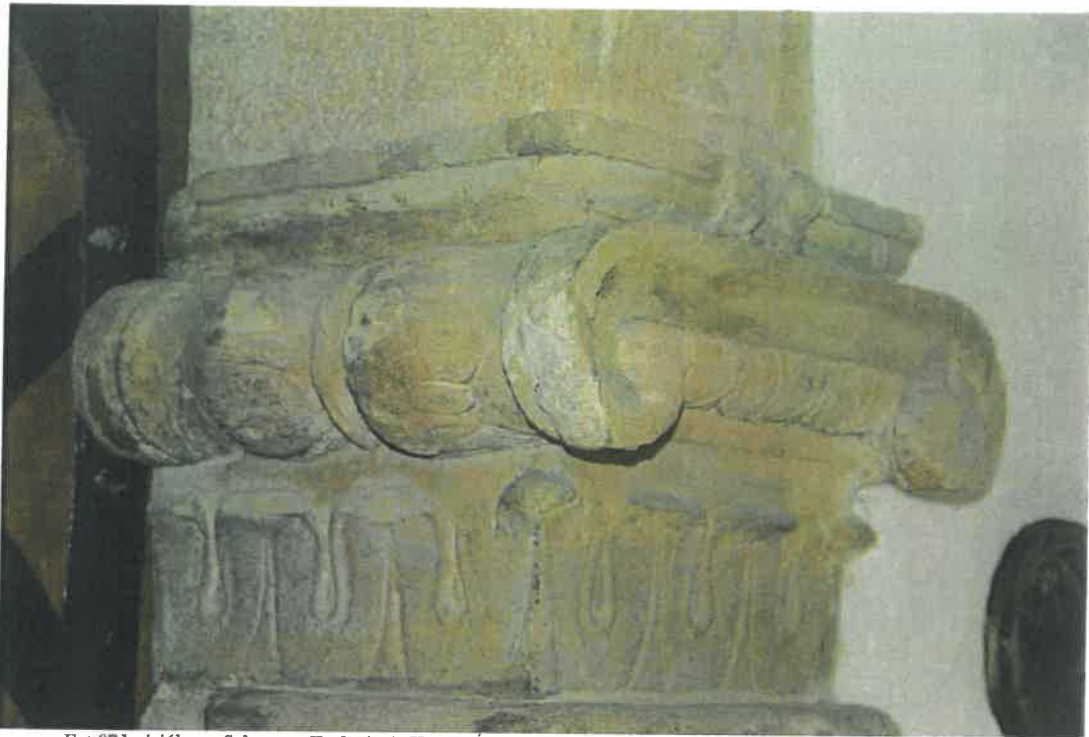
Fot. 87 kościół parafialny pw. Znalezienia Krzyża Świętego, w Łazanach. Elementy wystroju i wyposażenia wnętrza. Portal kamienny wejścia do kościoła z kruchty wejścia bocznego. Ubytki widoczne na głowicy prawego węgara.
