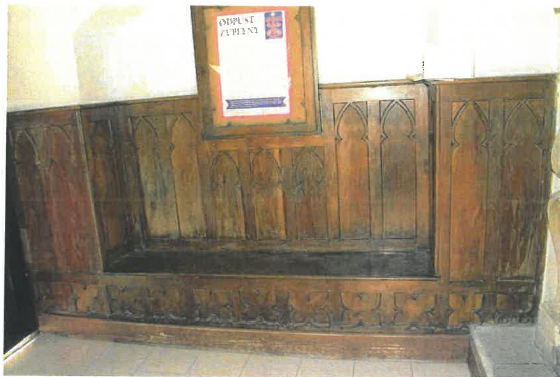
Fot. 70 kościół parafialny pw. Znalezienia Krzyża Świętego, w Łazanach. Elementy wystroju i wyposażenia wnętrza. Siedzisko na ścianie kruchty wejścia bocznego, do kościoła. Widoczne silne uszkodzenia warstwy lakierowej i wierzchnie drewna.
