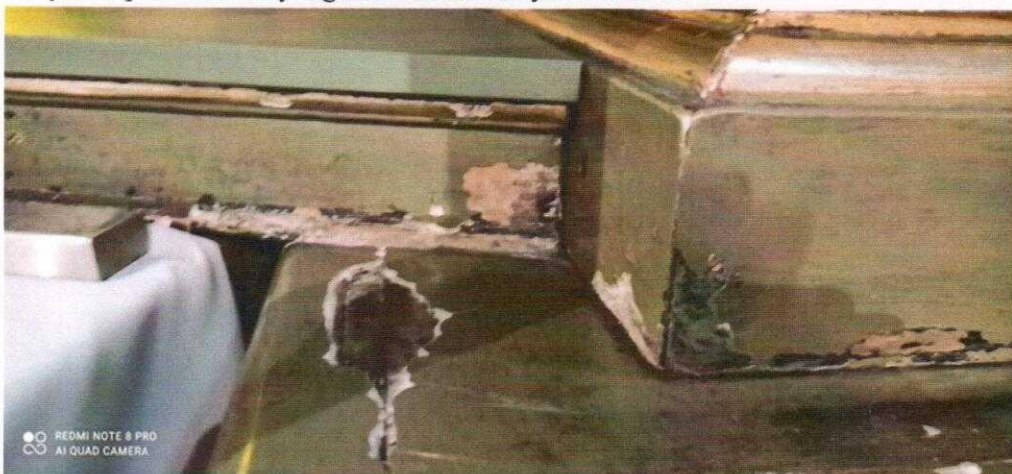
Fot. 5. Biskupice, kościół p.w. św. Marcina. Ołtarz główny, fragment podstawy cokołu poniżej kolumny i fragment blatu, widoczne wykruszające się warstwy technologiczne.
